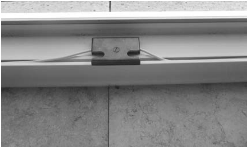
Bild 7: Angriffsmelder, installiert in einem Fenster [Matouschek]
