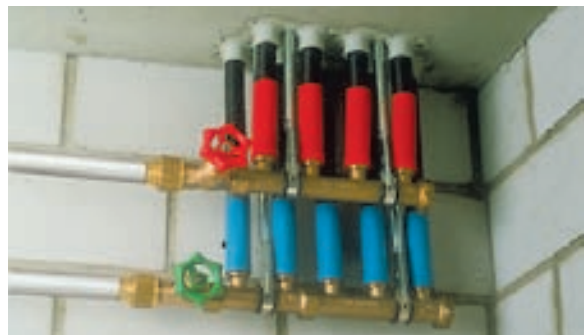
4 WW- und KW-Verteiler an der Kellerdeckenunterseite
