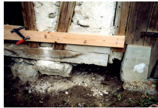
Der bestehende Schwellenbalken aus Kiefernholz ist nach ca. 100 Jahren durch Feuchtigkeit geschädigt [A].
