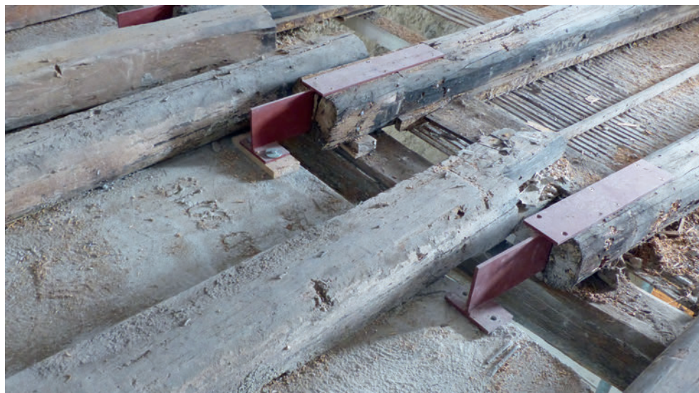
Altbaudecken können sich nach der Freilegung in sehr schlechtem Zustand zeigen.
