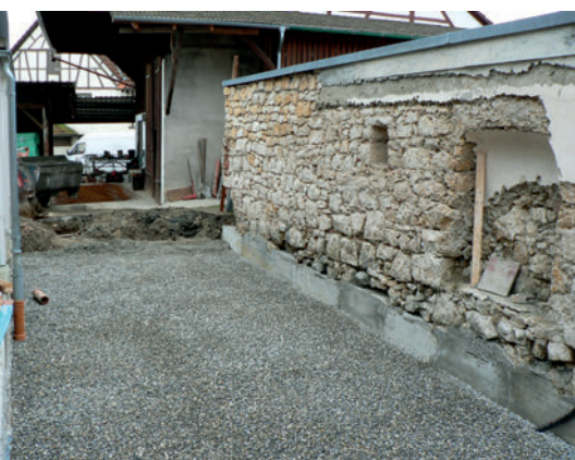
In Teilstücken wird die bestehende Natursteinwand nachträglich frosttief unterfangen. Das neue Betonfundament der Natursteinwand geht dann seitlich über in eine neue wasserdichte Bodenplatte über der Sauberkeits- und Dränschicht aus Rollkies [B2].
