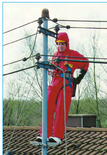
Bild 3: Elektrofachkraft mit isolierendem Schutzanzug
