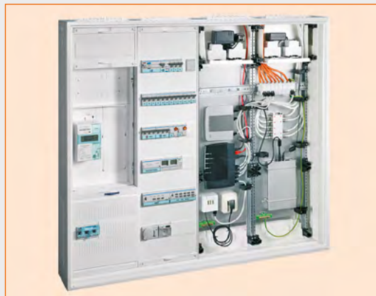
Bild 2: Zählerschrank mit Multimediaverteilerfeld
