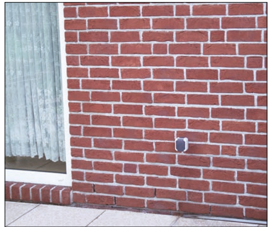
Bild 1: Außensteckdose an der Außenwand
